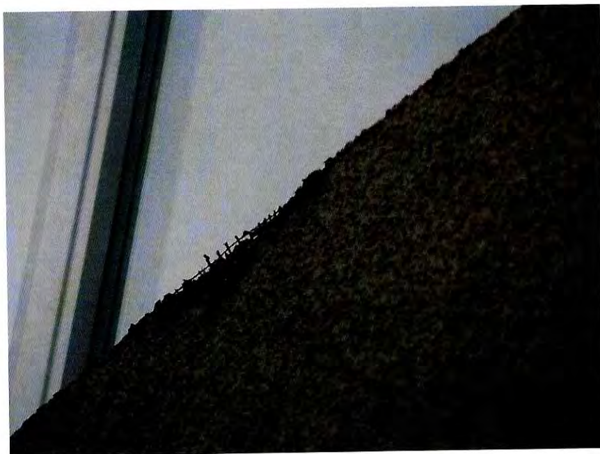
Fotografía N° 4: Desprendimiento del revestimiento en la ventana del segundo piso.
