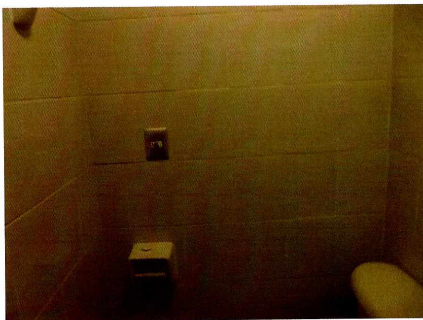
Fotografía N° 6: Revestimiento de cerámicas de muros de los baños, no cumplen con las dimensiones especificadas.
