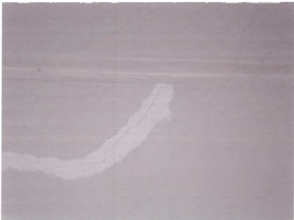
Fotografía 6: Fisuras en muros interiores.
