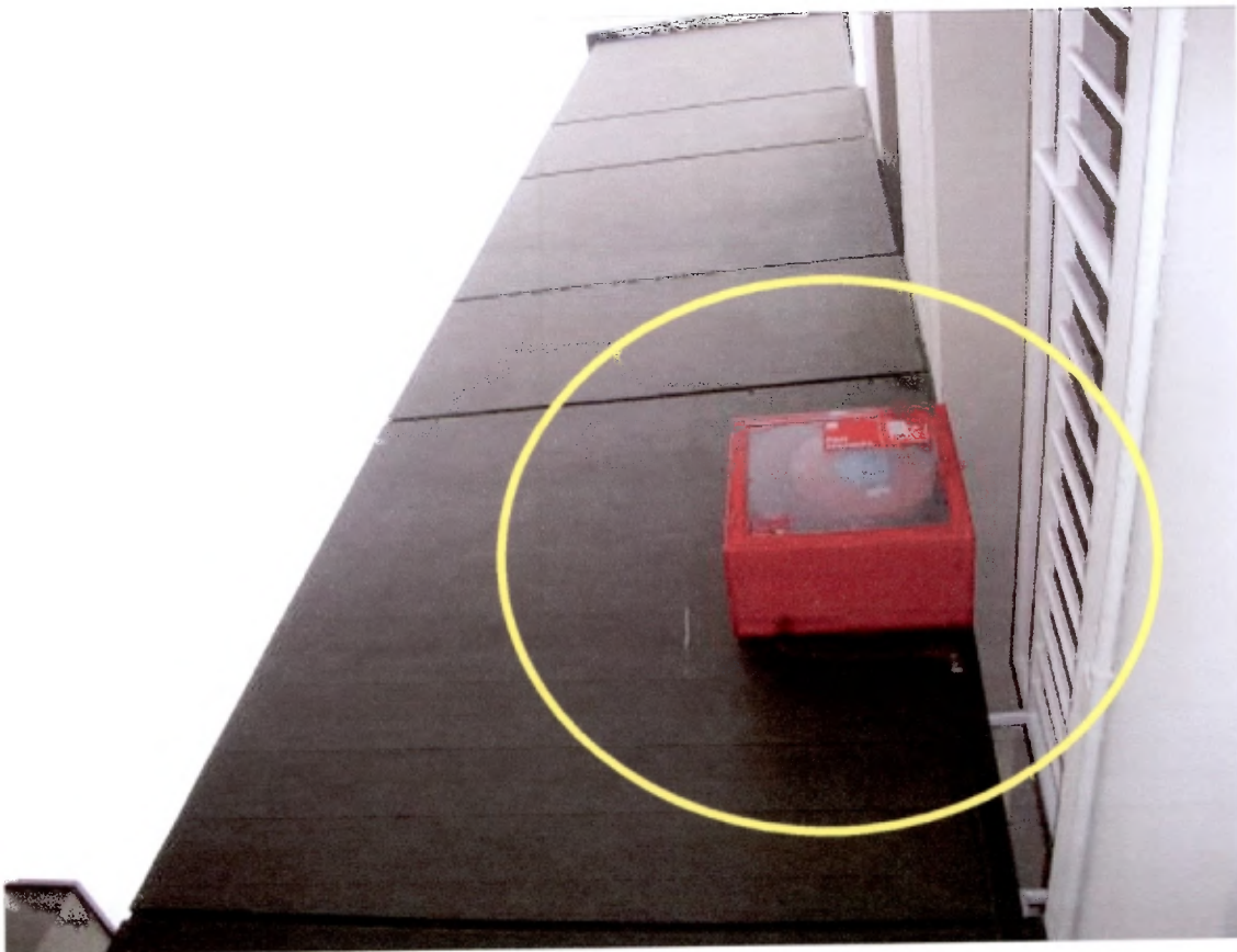
Fotografía 9: Ubicación de gabinete de red húmeda.
