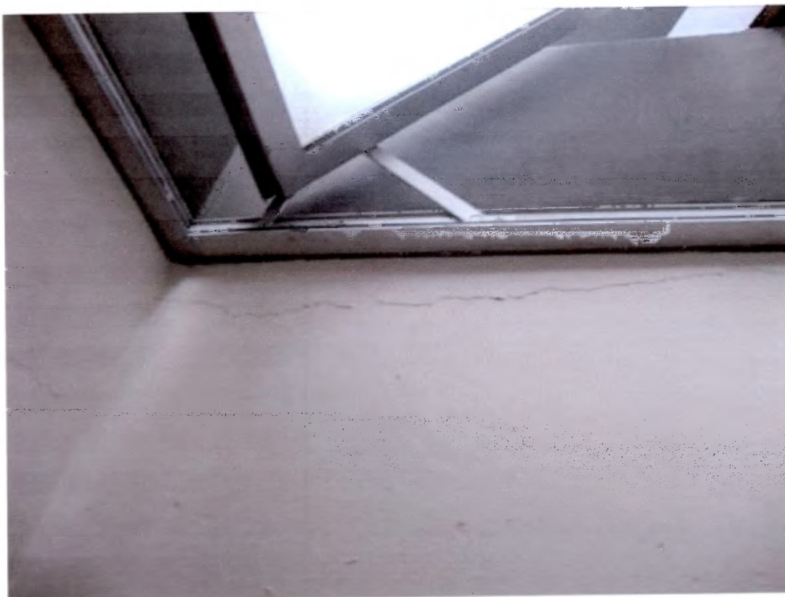
Fotografía 8: Fisuras en muros interiores.
