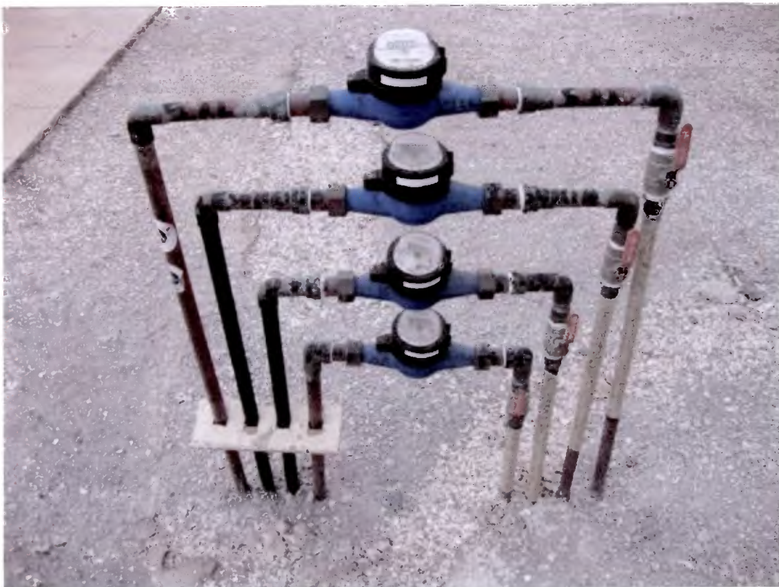
Fotografía 11: Ubicación remarcadores de agua potable.
