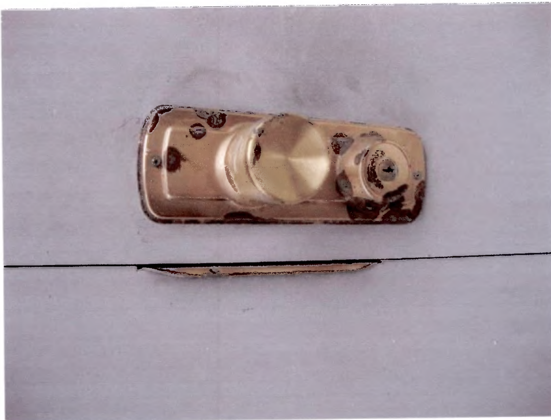
Fotografía 7: Oxidación en cerraduras exteriores.
