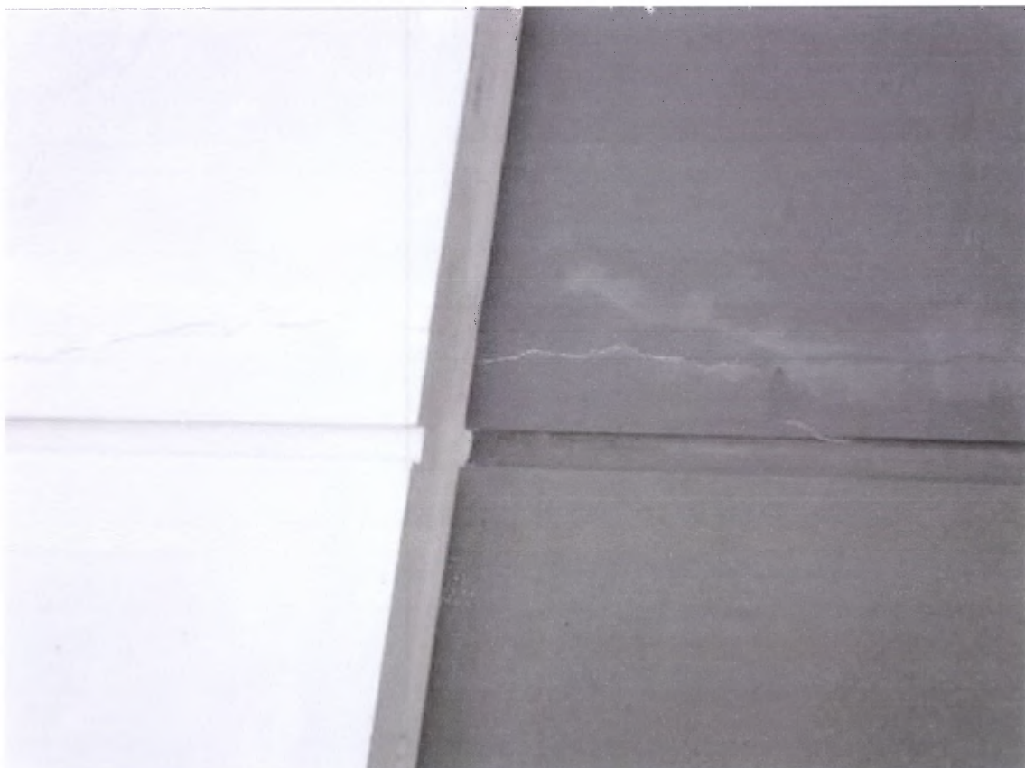
Fotografía 3: Fisuras en muro.
