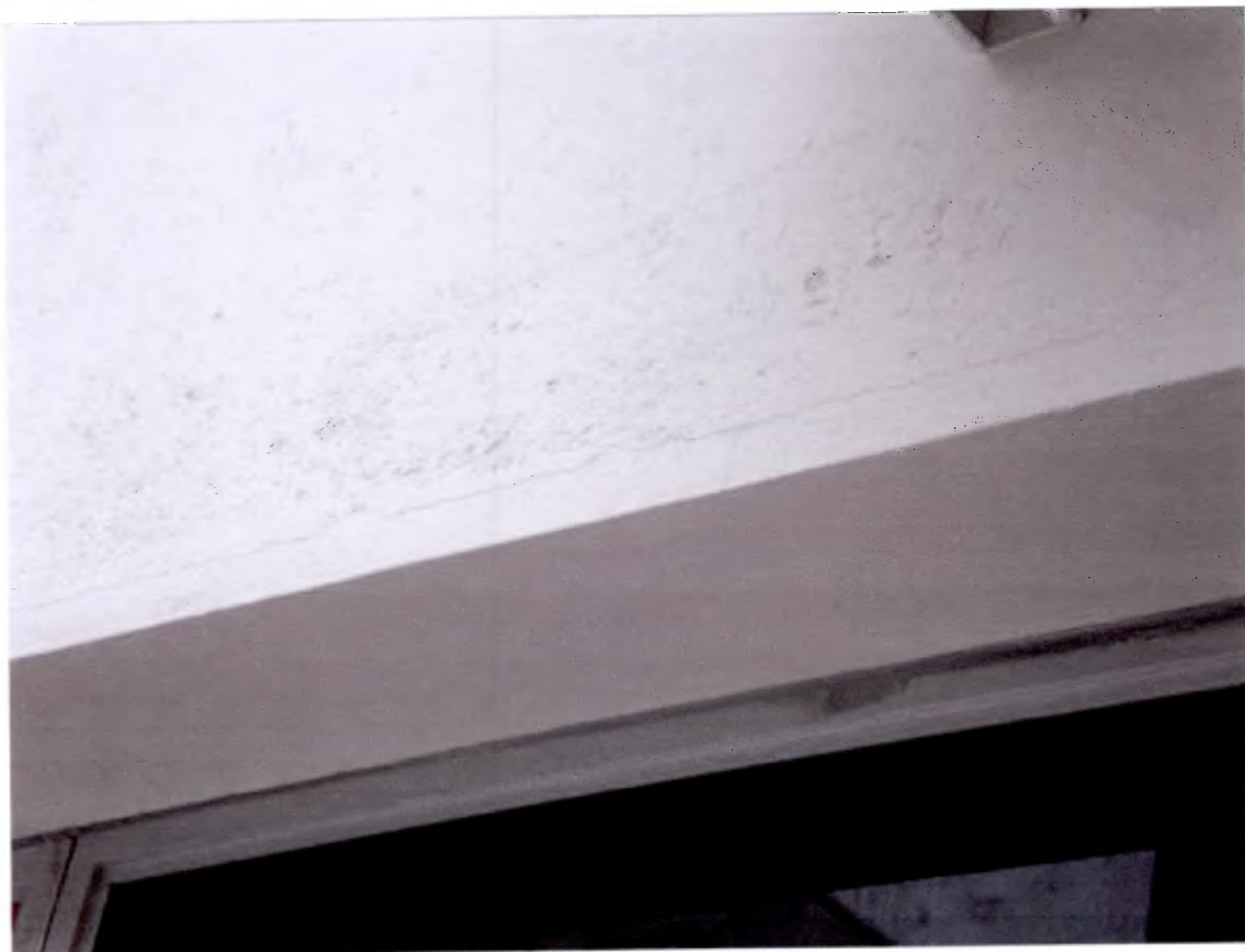
Fotografía 4: Fisura en estuco de premarco.
