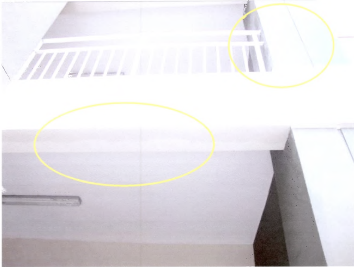
Fotografía 2: Aplicación de pintura de distinto color, revestimiento “descascarado”.
